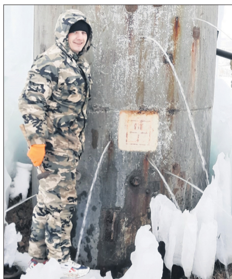
Состояние некоторых объектов водоснабжения не просто неудовлетворительное. ФОТО ИЗ АРХИВА ПРЕДПРИЯТИЯ.
