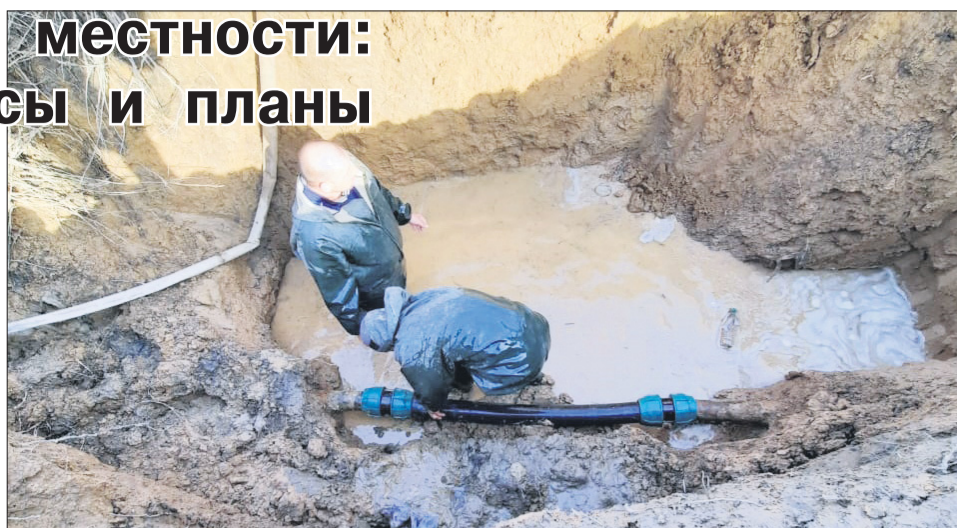
В таких условиях приходится работать бригаде управления, чтобы ликвидировать порывы водопроводов. ФОТО ИЗ АРХИВА ПРЕДПРИЯТИЯ.
