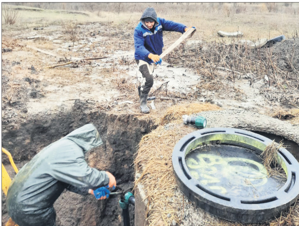
Опыт работы и мастерство помогают слесарям оперативно восстанавливать аварийные участки сети. ФОТО ИЗ АРХИВА ПРЕДПРИЯТИЯ.
